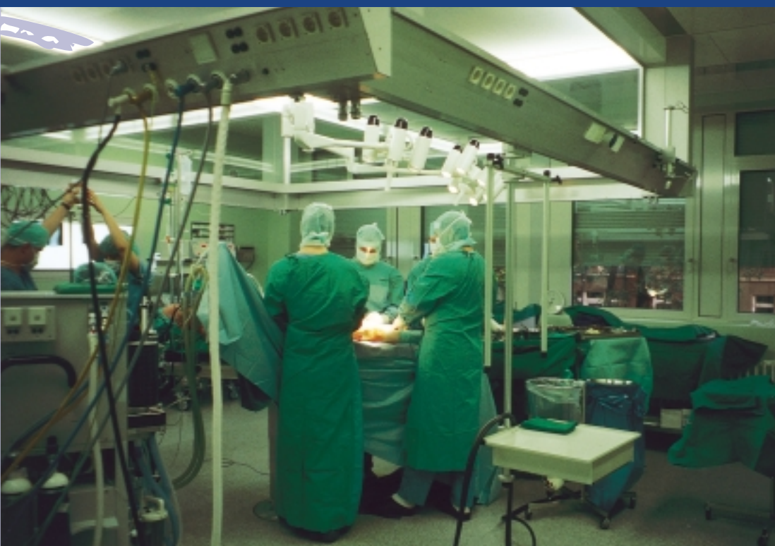
OP-Saal 5, Werner-Forsmann-Krankenhaus in Eberswalde mit lufttechnischen Bauelementen von Westaflex
